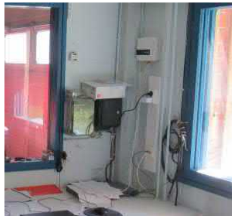
Käyttäjien laitteiden sähköistystä toimistossa
