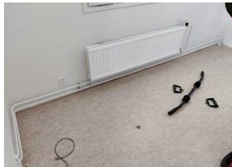
Lämpölinjat kulkevat toimistoissa pinnassa läm-mityspattereiden alla
