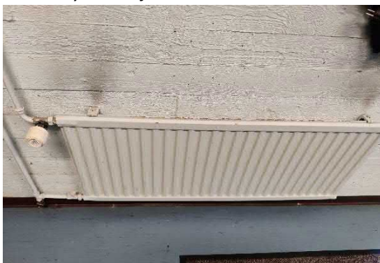
Korroosiota ja maalin irtoamista lämmityspatterin päällä
