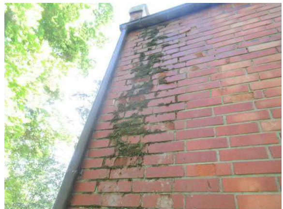
Valumajälkiä, todennäköisesti peräisin vaurioituneesta sadevesikourusta
