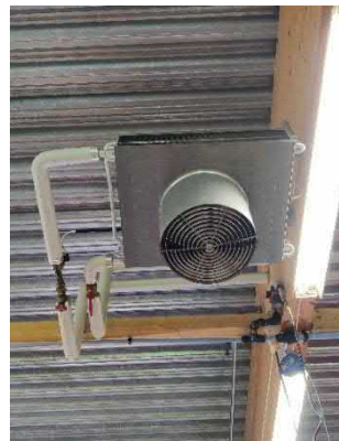
Kiertoilmakoneen kytkentä ja magneettiventtiili
