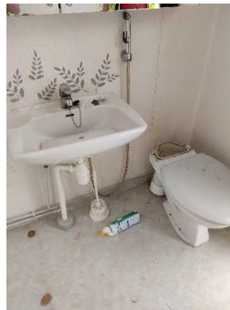
Alkuperäisen WC, suihkutilan WC:stä puuttuu vesisäiliö, suositellaan korjattavaksi.
