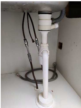
Keittiön allaskaapin viemärointi ja hanaliitokset, kytkentäjohtojen kannakointi puuttuu.
