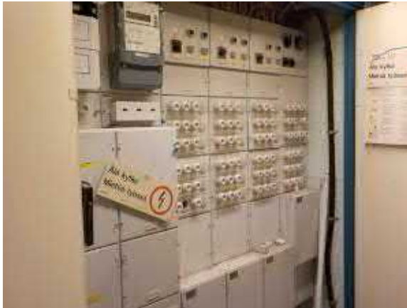
Pääkeskus käytävän keskuskomeroissa
