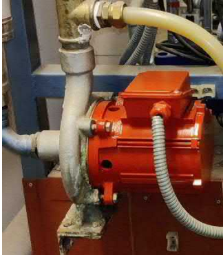
Vuotoa/korroosiota pumpun yhteydessä.
