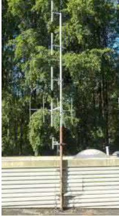
Masto antennineen vesikatolla
