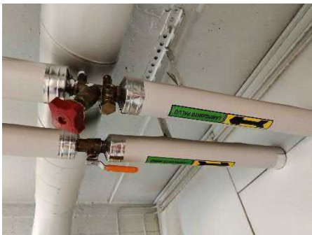
Lämpöjohdoissa olevat sulku ja linjasäätöventtiilit
