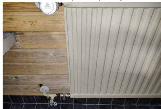
Korroosiota lämmityspatterin kytkennässä/yhdistäjässä
