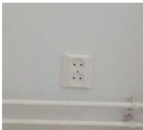
Maadoittamaton pistorasia yläkerran asunnossa
