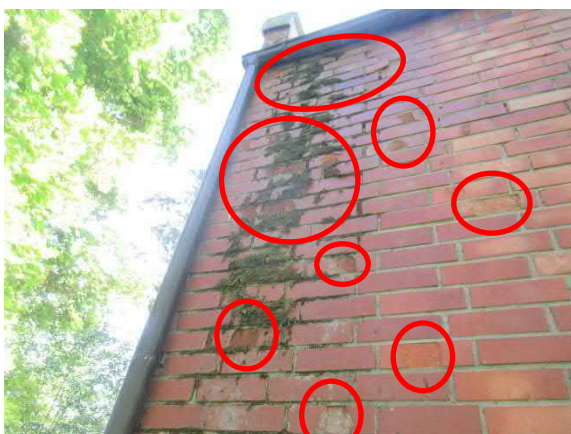
Pohjoiskulmauksen valumajälkiä, rapautuneita tiiliä (punainen ympyröinti)
