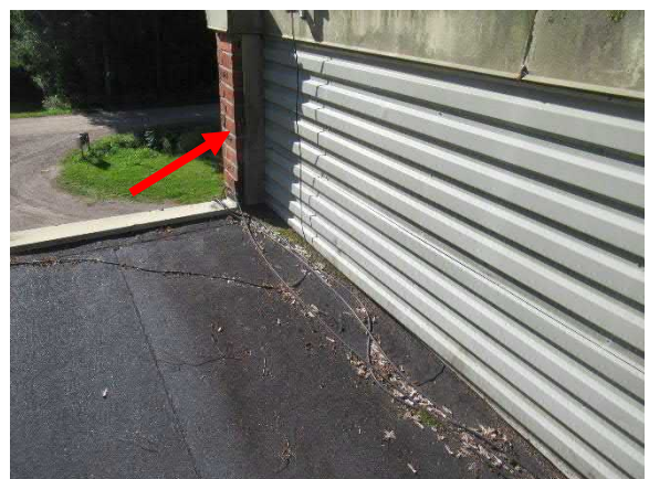
2. kerroksen pellitetty julkisivu matalamman osan yläpuolella, pellityksen liitoksessa epätiivis kohta (punainen nuoli)
