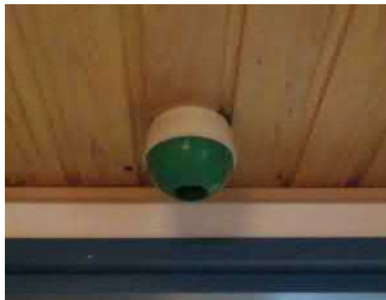
Poistumisvalaisin oven päällä pukuhuoneessa
