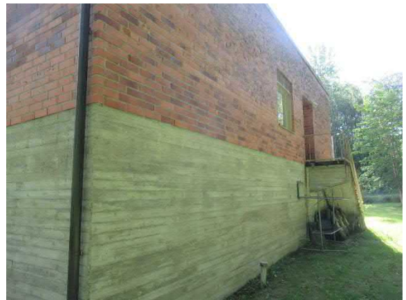
Yleiskuva päätyjulkisivusta (lounaaseen), muurauksessa sammalkasvustoa
