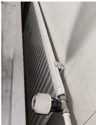
Patterikytkeä ja termostaatti
