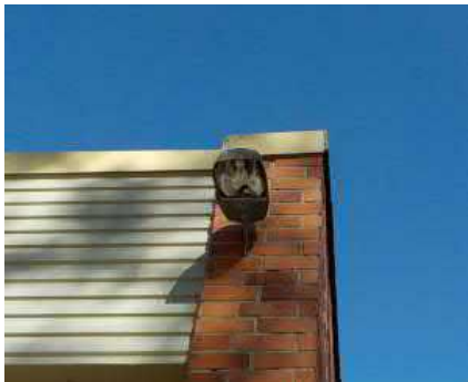
Ulkovalaisin seinään asennettuna
